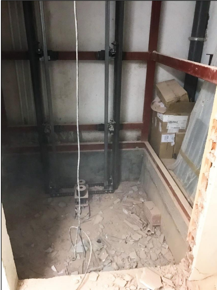
Figura 7. Les obres del fossat de l'ascensor ja estaven finalitzades a l'inici de la intervenció
